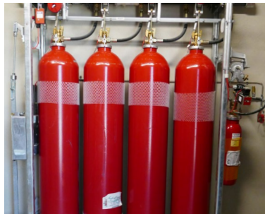
Abb. 19 und 20 Kohlendioxidlöscher und Gaslöschanlage
